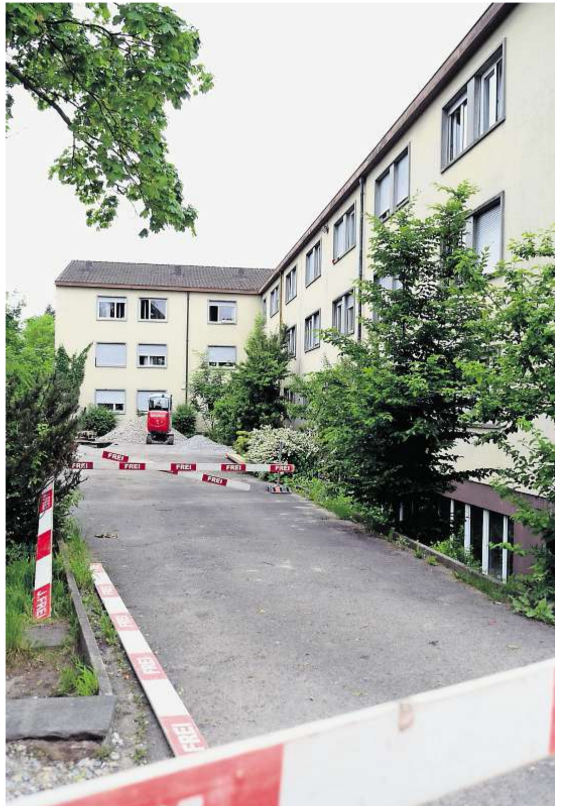
Das Wohnheim an der Hegifeldstrasse ist in schlechtem Zustand. Doch renovieren ist günstiger als neu bauen. mad
