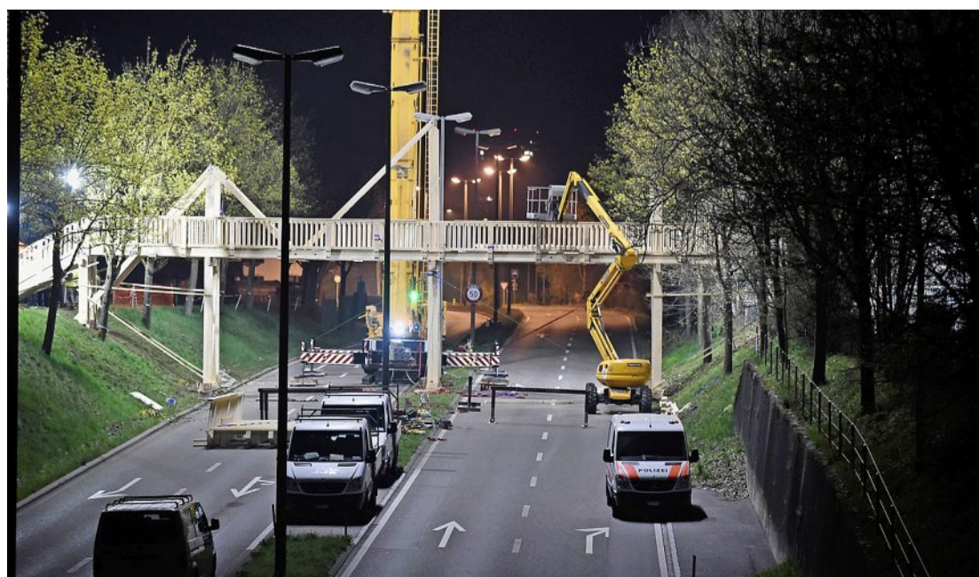
In der Nacht vom 11. April wurde die Brücke über die Salomon-Hirzel-Strasse aufgebaut. Foto: Heinz Diener
